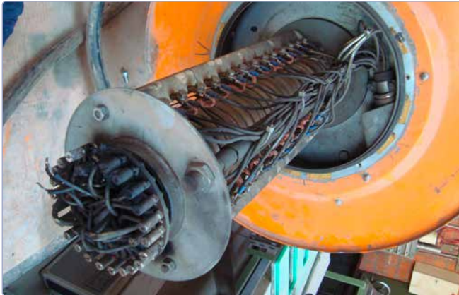
Alter Schleifringkörper (Fremdfabrikat, keine Ersatzteile mehr)
